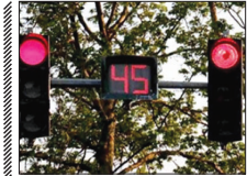
تجهیز ۵۰ تقاطع کلیدی اصفهان به برق اضطراری
