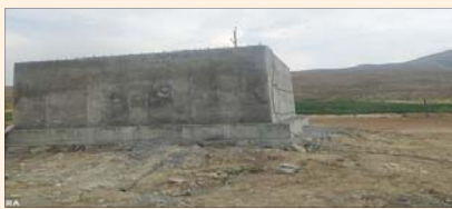
محل پروژه: شهرستان فردوسشهر تعداد خانوار بهره بردار: ۲۰۰ خانوار طول خط انتقال آب: ۲۵۰ متر حجم منبع ذخیره آب: ۵۰ متر مکعب
