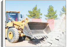
تخریب ساخت و سازهای غیرمجاز شدت گرفت
